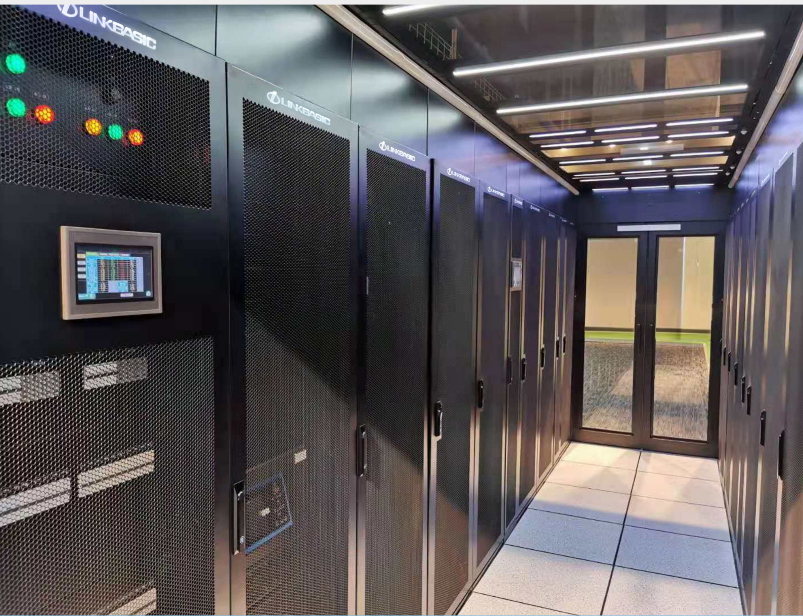
M1系列微模块数据中心内景
